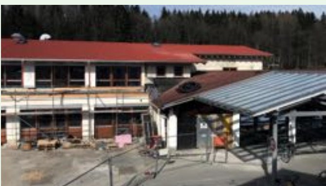
März 2019 - Der Mehrzweckraum über der Dienstleistung 8 (ehemalige Wäscherei) ist fast fertig. Der Kran wurde abgebaut. Bald beginnt die Baustelle für die Außenanlagen.
